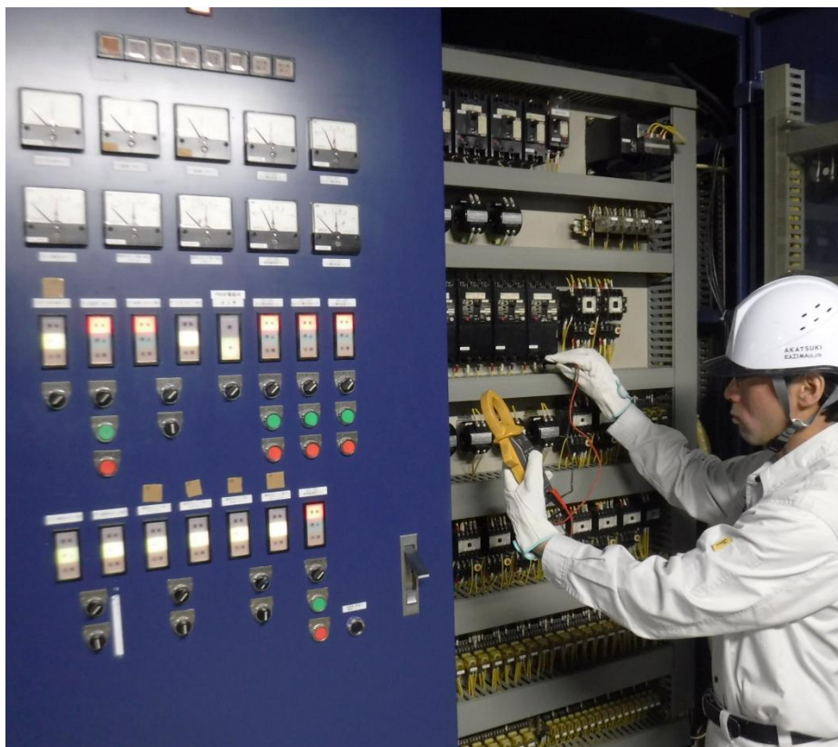
空調機制御盤点検
