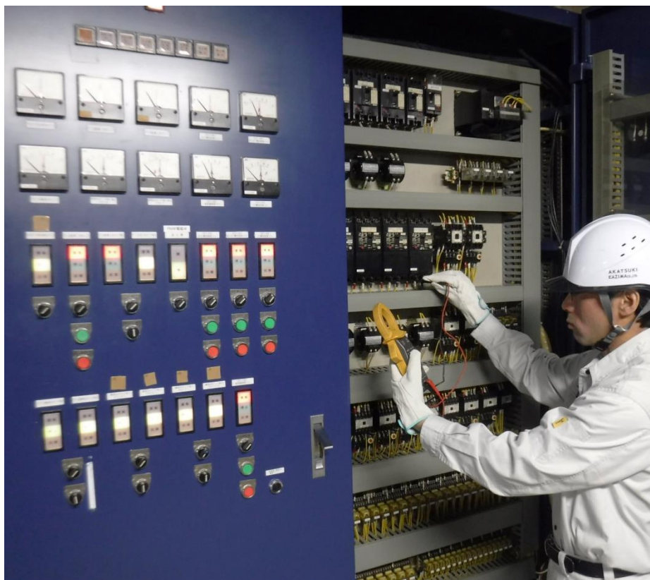
空調機制御盤点検
